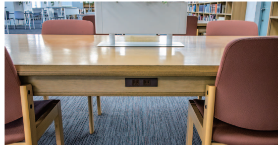
図3 電源コンセント
