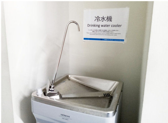
図6 ノズル装着後の冷水器（湘南藤沢）
